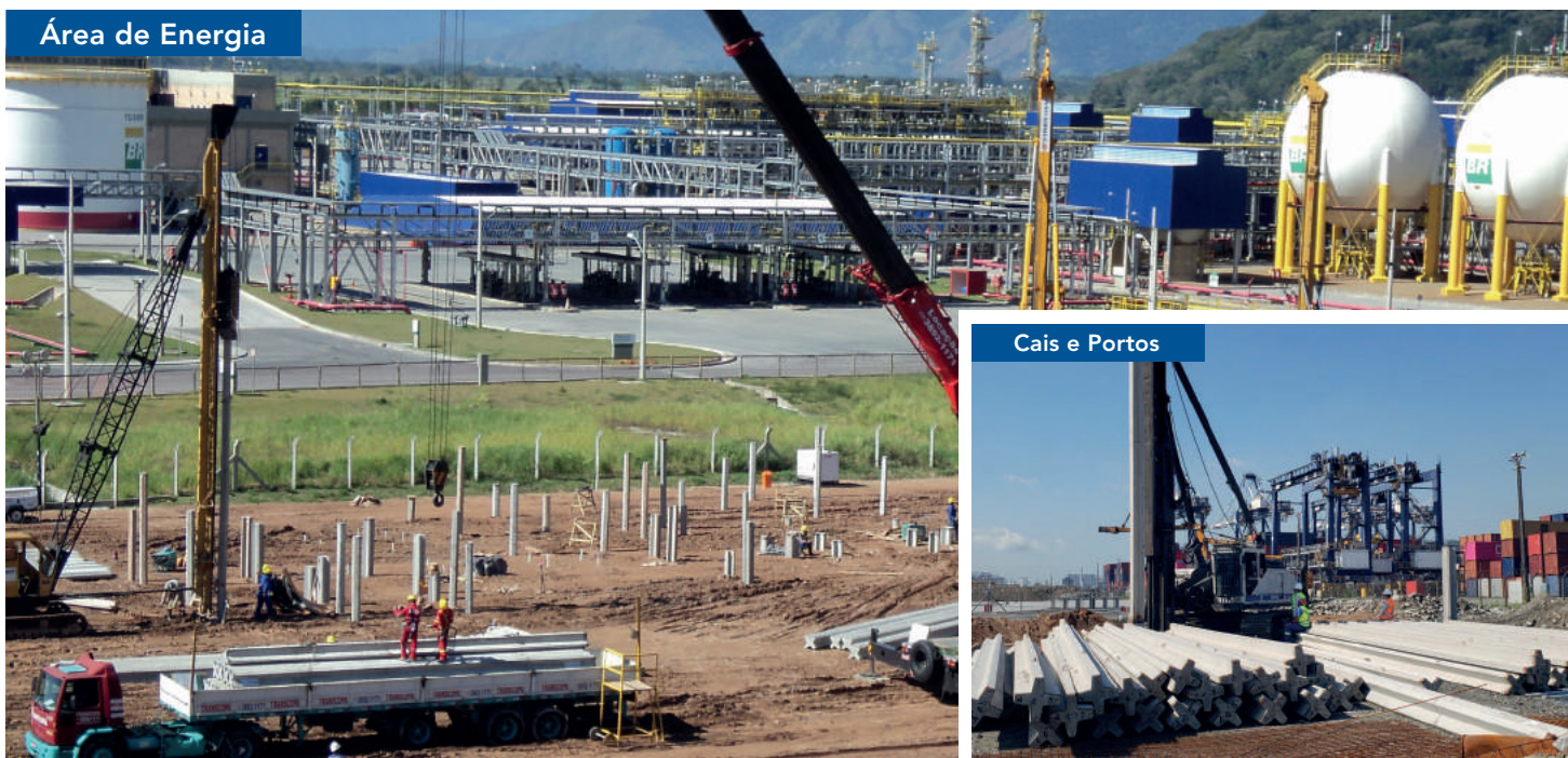
Tratamento de Gás - Caraguatatuba - SP - 300.000 m
